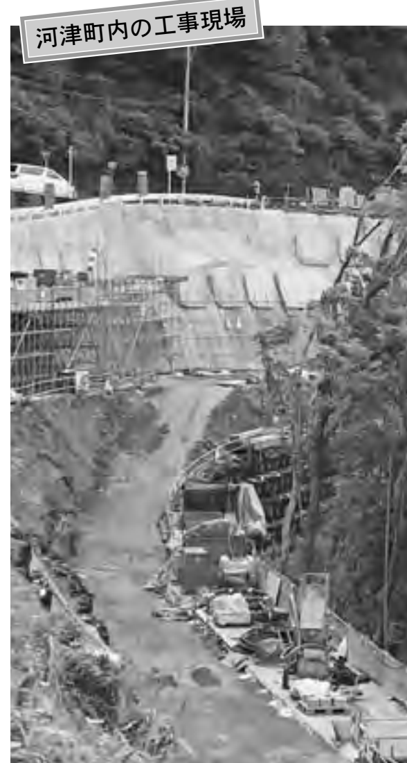
伊豆縦貫道路 大鍋入口
