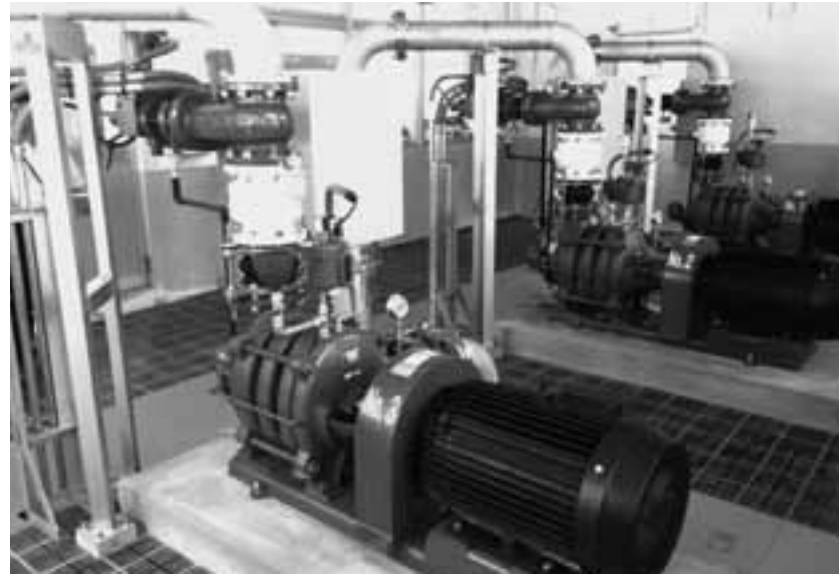
平成29年度に更新された大堰浄水場ポンプ
