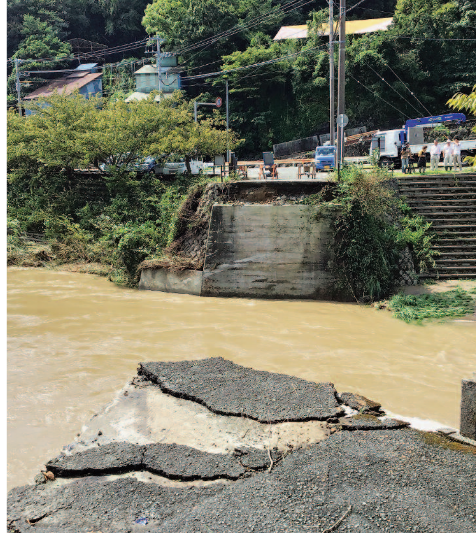
崩落した峰橋（かつば橋）
