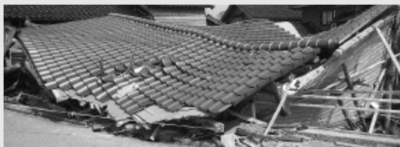
能登半島地震（平成19年）で倒壊した木造住宅 （写真提供：県建築安全推進室）
