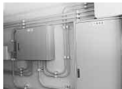
集電盤に発電した電気を集めて、学校で使用できる電気に変換します
