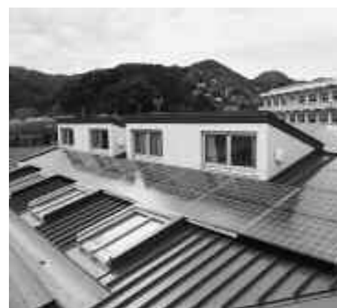
さくら幼稚園の屋根に設置された太陽光パネル （平成22年3月設置）
