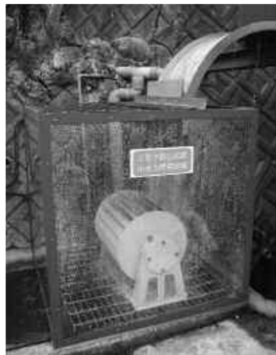
上佐ヶ野公民館横に設置された小水力発電機
