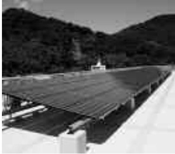
太陽光発電システム
