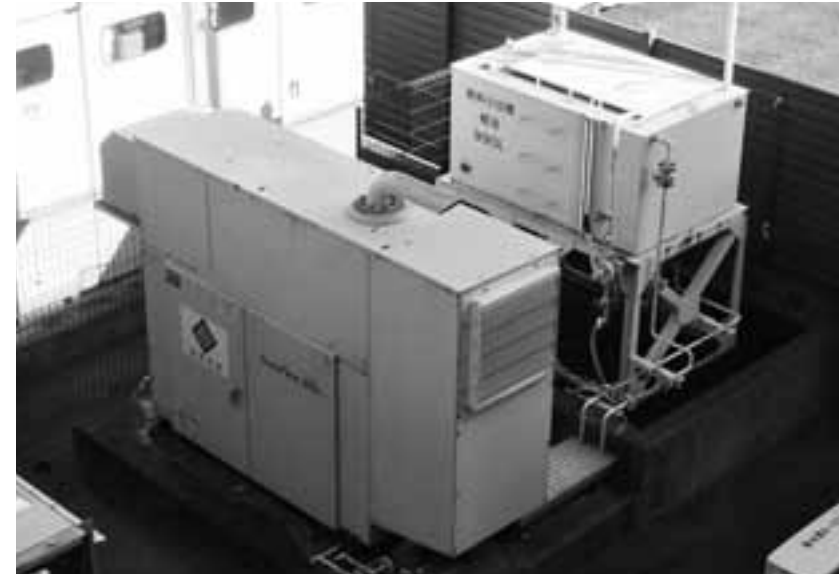
役場庁舎の非常用発電機と燃料タンク
