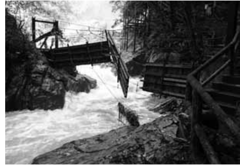
台風15号による釜滝（梨本）のつり橋崩落
