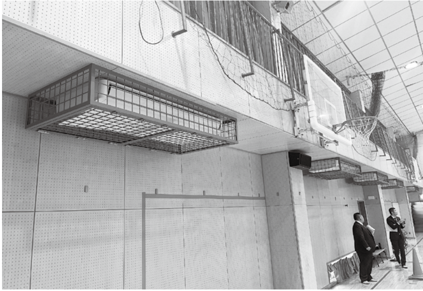
既存の体育館に後付けしたエアコン
