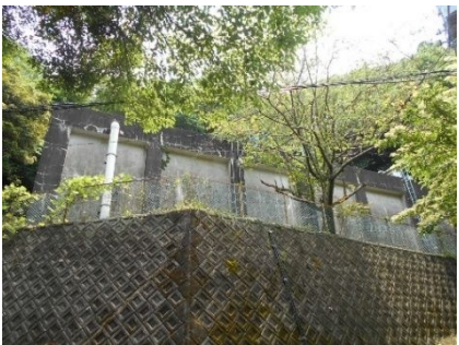
写真 6-2 今井浜配水池
