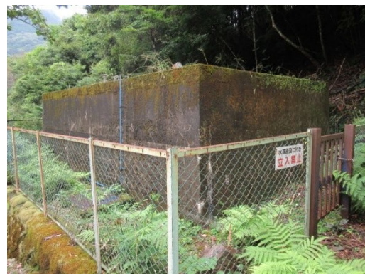
写真 3-6 大鍋第一配水池
