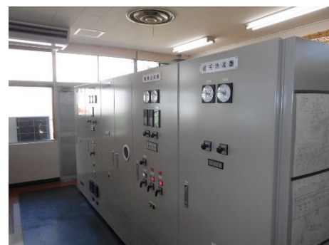
写真 3-4 計装盤 (制御盤)
