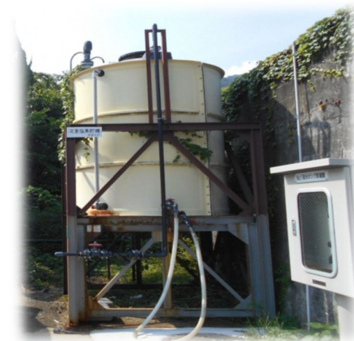
写真 3-2 大堰浄水場 （次亜塩素酸ナトリウム溶液のポンプ）
